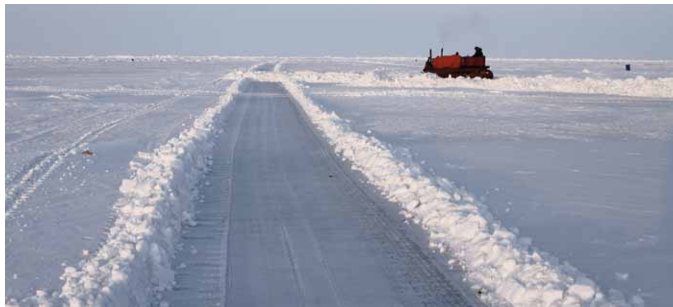
Kaum sind die Kettentraktoren ausgepackt und funktionstüchtig, beginnt die Arbeit: Die Landepiste wird planiert.
